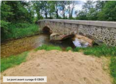
Le pont avant curage © EBER
